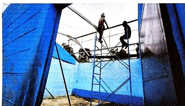
Foto 3: Sustrucción de vigas y costaneras en mal estado de las tres aulas.
